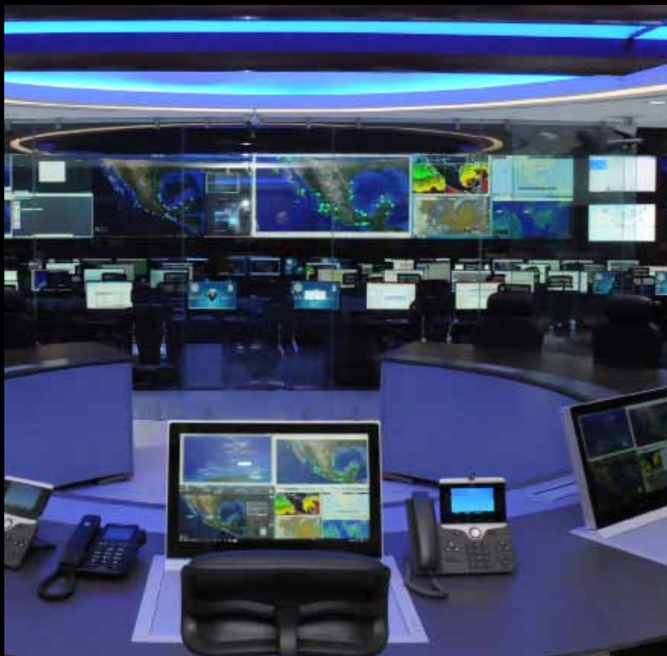
Instalaciones del Centro de Mando y Control.
